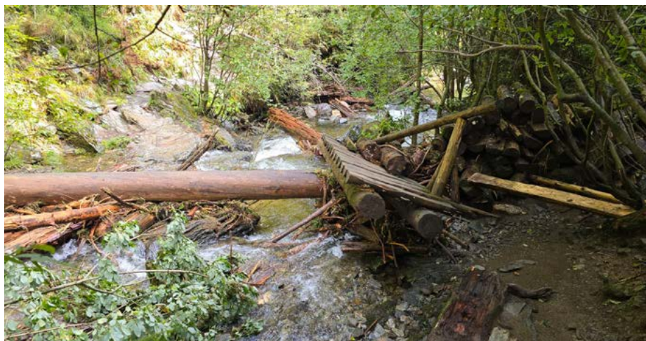
► Voda z jarního tání škodí v údolí Bílé Opavy pravidelně. Ale to, co napáchala loňská povodeň, se hned tak nevidí. I proto se oprava lávek, a tím pádem i uzávěra žluté turistické trasy, protáhne.
