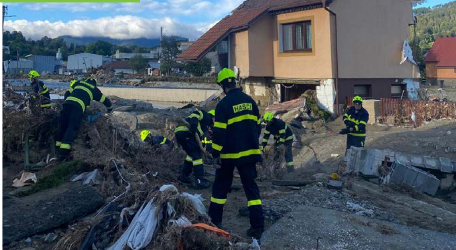
► Dotační program ŽIVEL má několik kategorií. Ten s číslovkou 3 je určený na opravu poškozených domů. foto:red
