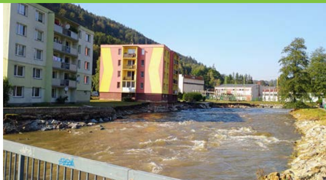
► Poškozené koryto Moravy v Hanušovicích.
